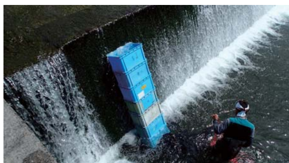
図5 簡易魚道の設置作業。上：土のうを敷き河床の凹凸を相殺し、その上から堰に立て掛けるように加工したコンテナボックスを積み上げていく。下：コンテナボックスを7段まで積み上げた様子
